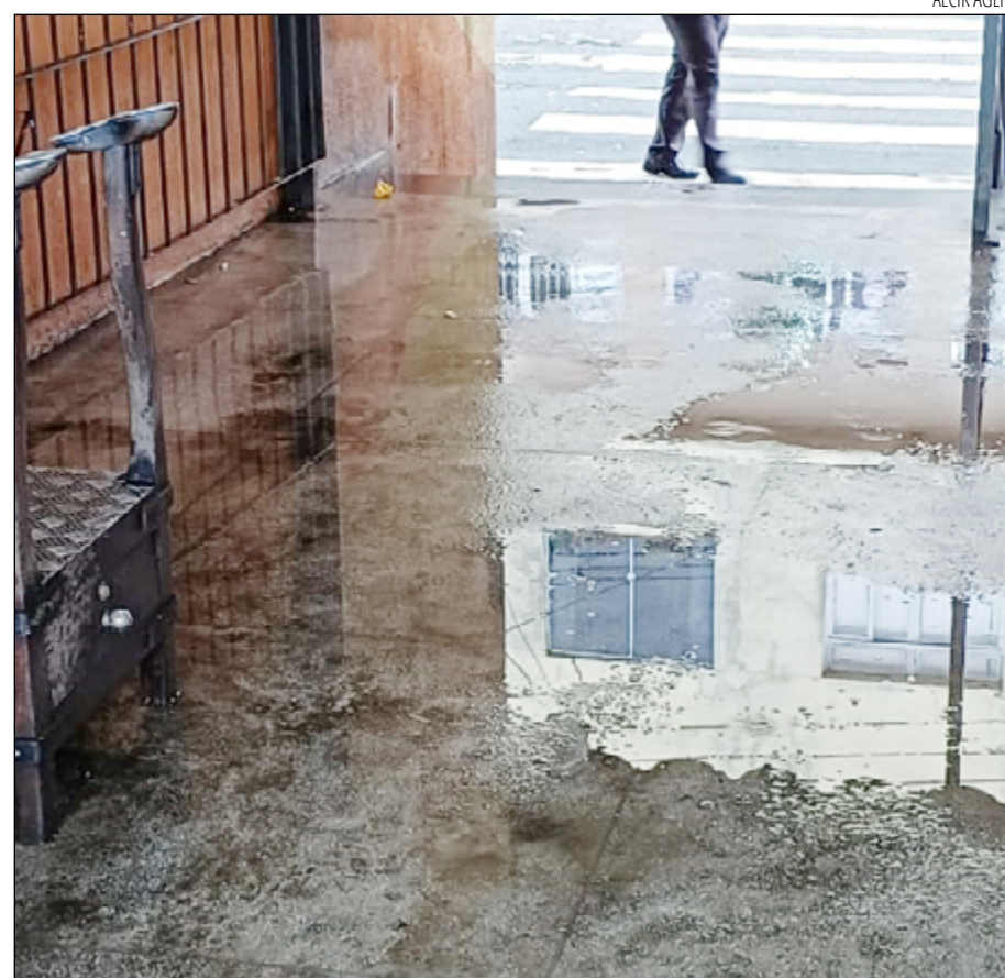
SEGUNDO passageiros, mesmo sendo coberto, chove dentro do terminal
