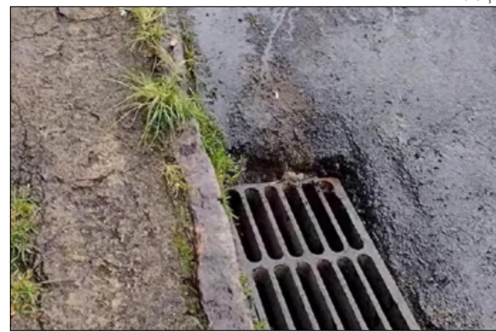
MORADORES relataram que o bueiro não tem passagem
