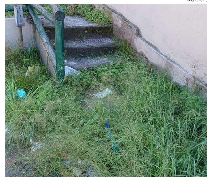
FALTA de capina
