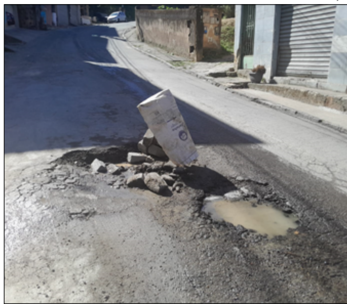
VÁRIOS pedidos de reparos foram feitos pelos moradores
