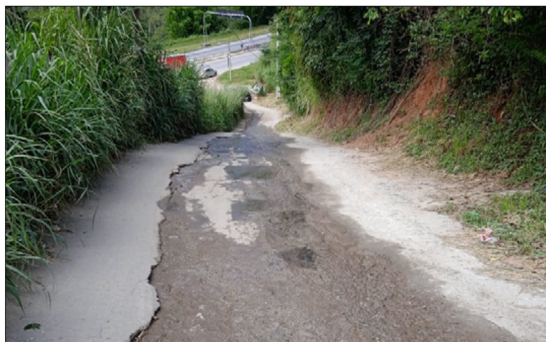
VAZAMENTO de esgoto já dura cerca de um mês e incomoda muito os moradores da Comunidade
