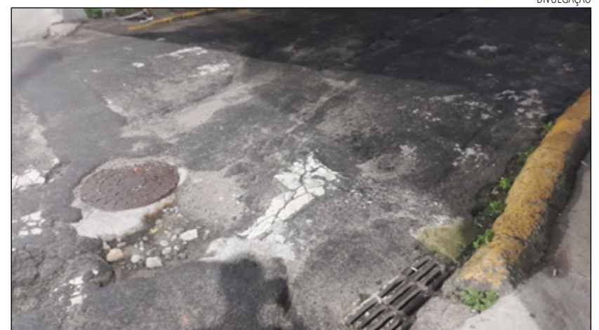
RUA DA Vila São José em péssimas condições gera muitas reclamações
