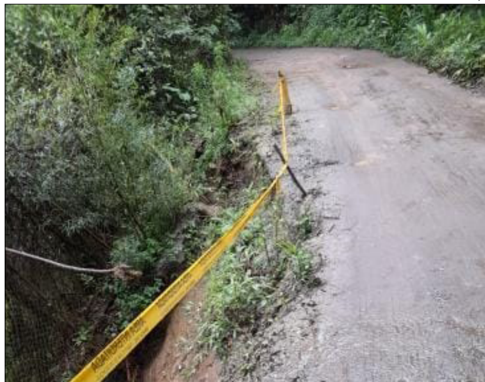
DESDE março que moradores e motoristas convivem com o deslizamento de terra
