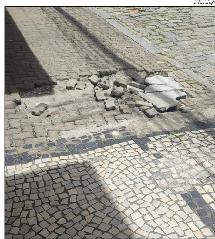
BURACOS, rachaduras ou desníveis podem causar acidentes
