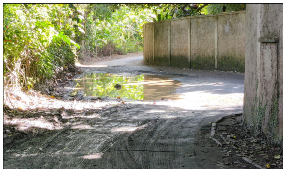
VIA ALTERNATIVA para fugir de engarrafamentos em Itaipava está em estado precário
