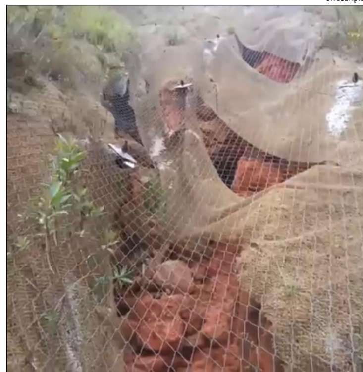
MORADORES apontam afundamento do solo e rachaduras no concreto da obra de contenção na Rua Nova
