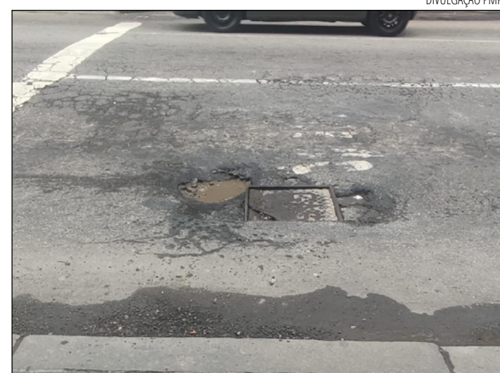
MOTORISTAS e pedestres estão preocupados com o buraco
